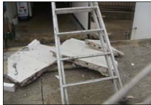
脱落した「ひさし部」
