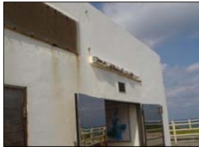
脱落時の状況
