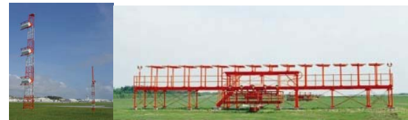
【計器着陸装置】
