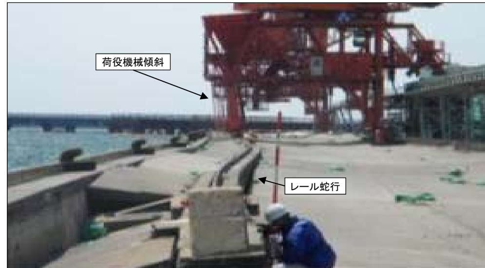
東日本大震災における施設被災状況
