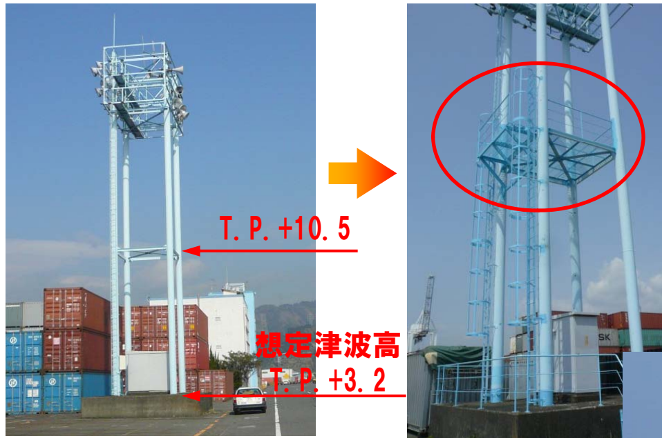
既存照明塔を利用した整備(3次想定での対応状況)
