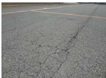
(老朽化した基本施設舗装)
