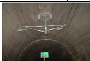
下束(架線を吊る金物)
