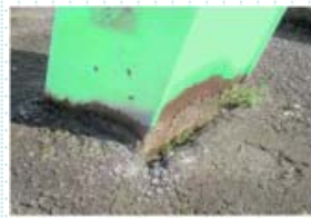
埋込部の腐食
