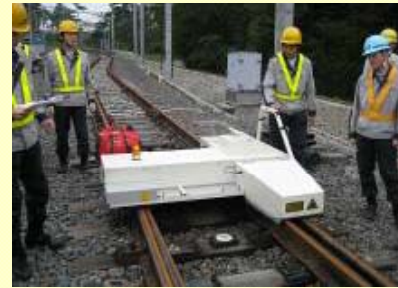
分岐器検査装置
