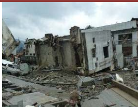
RC造転倒建築物の詳細検討
