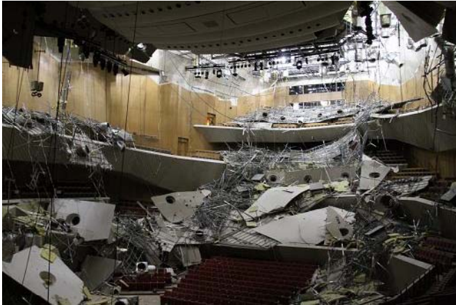
音楽ホールにおける天井の脱落
