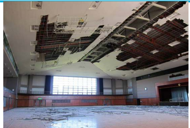
体育館における天井の脱落
