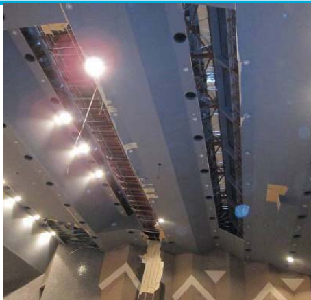
ホールにおける天井の脱落
