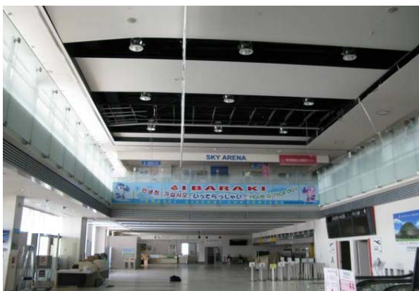
旅客施設における天井の脱落
