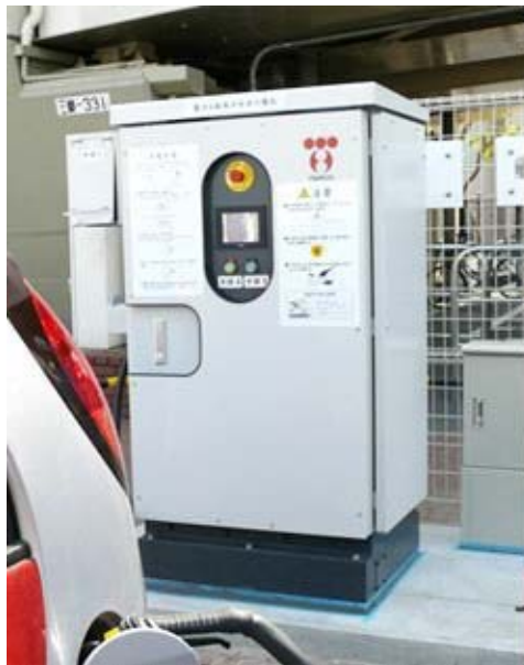
図4-29 パーキングエリアに設置された電気自動車用急速充電器
