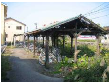
図 1-2-7 老朽化が見られる駐輪場
