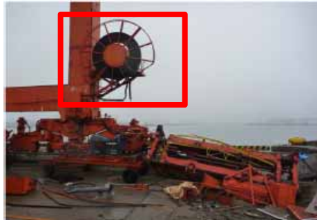
漂流物による巻取装置の破損
