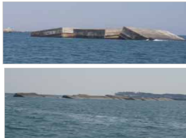
沖防波堤の被災状況
