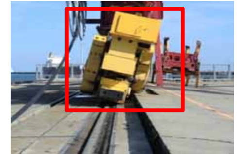
走行部の損傷
