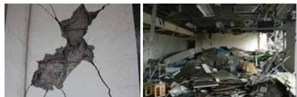
【地震による被害】
