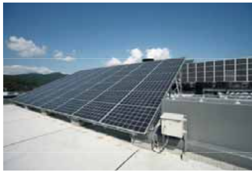
太陽光発電システム Solar power sites
