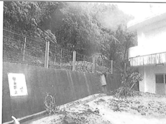
山腹崩壊状況
