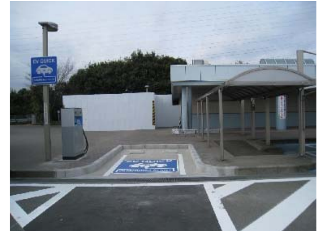
EV充電施設の設置事例 (第三京浜道路(都築PA))
