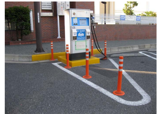
EV充電施設の設置事例 (首都高速道路(大黒PA))
