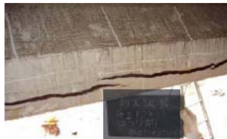
PC橋に発生したひび割れ
