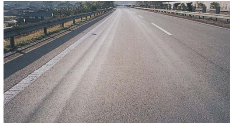
路面のわだち掘れ
