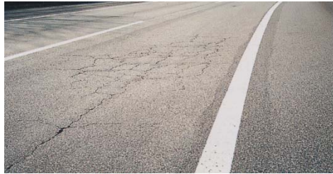
路面のひび割れ
