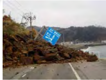
写真1 国道249号の被災状況 (能登半島地震時)
