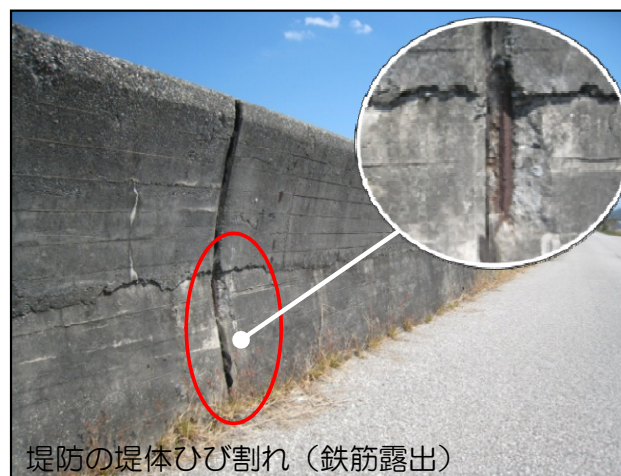
海岸保全施設の老朽化状況
