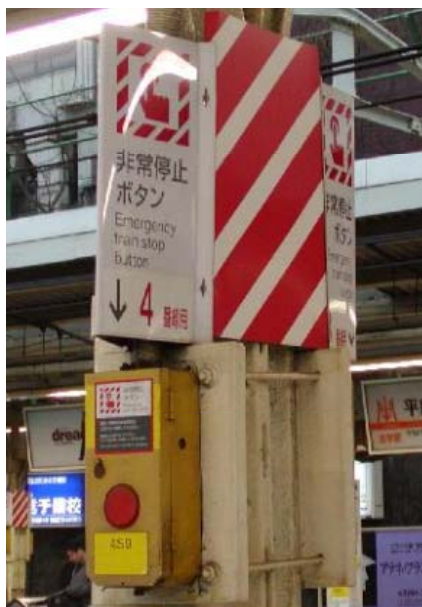
【非常停止押しボタン】
