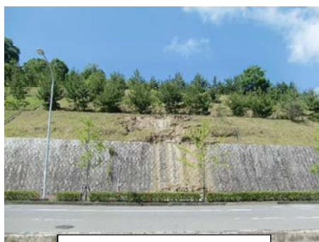
被害状況写真①
