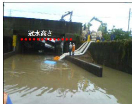
被害現場冠水状況写真
