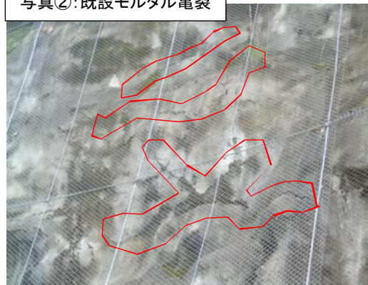
写真②:既設モルタル亀裂
