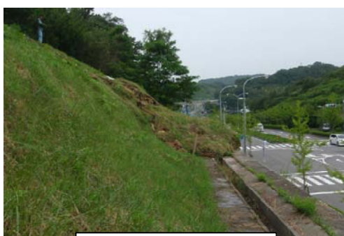
被害状況写真②
