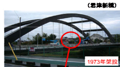
2008年10月にアーチ橋の吊材が破断
