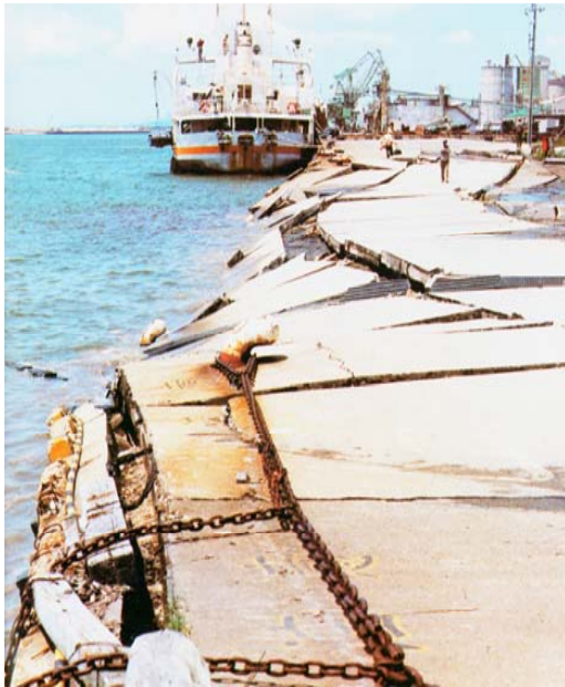
写真1 津波による防波堤被害(能代港)
