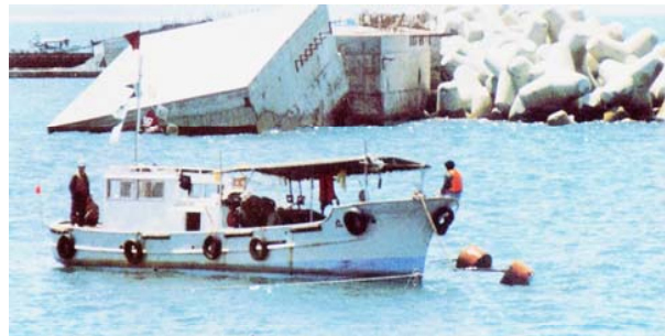
写真2 液状化、地震動による岸壁被害(秋田港)
