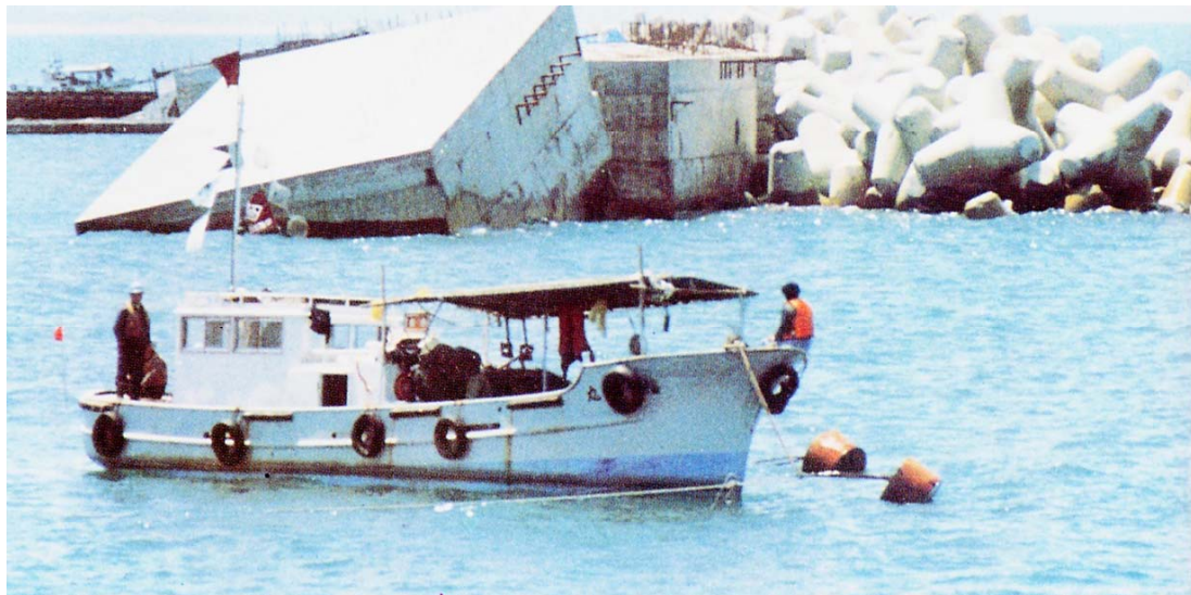
写真1 津波による防波堤被害(能代港)
