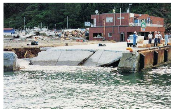
写真2 エプロンが傾斜したフェリー埠頭(奥尻港)
