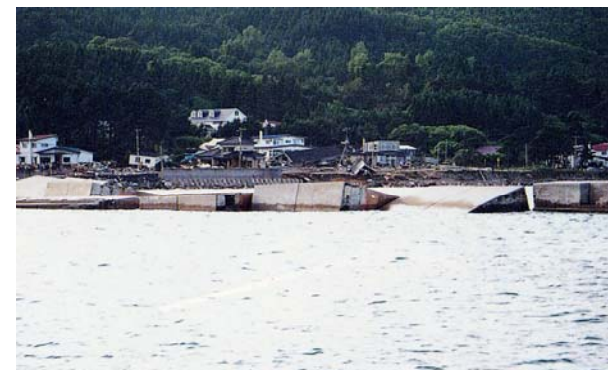
写真1 ケーソンが転倒した防波堤(奥尻港)
