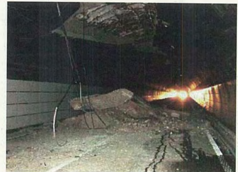
トンネルの崩落
