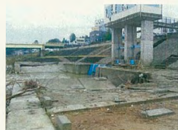
水門、低水護岸の破損
