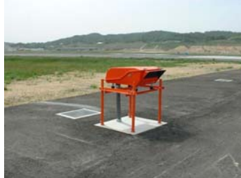
進入角指示灯
